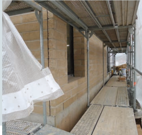
Blick vom Baustellengerüst auf die fertige Vormauerung. Die Erdsteine benötigen Dehnungsfugen in regelmässigen Abständen.
