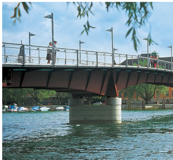
Fussgänger- und Velobrücke über den Seerhein in Konstanz: Der Kastenträger ist gevoutet und spannt über drei Felder. Der Kragarm wurde ohne Untergurt als T-Träger mit dickerem Steg ausgebildet, um den Wasserabfluss zu optimieren (siehe Plan).
