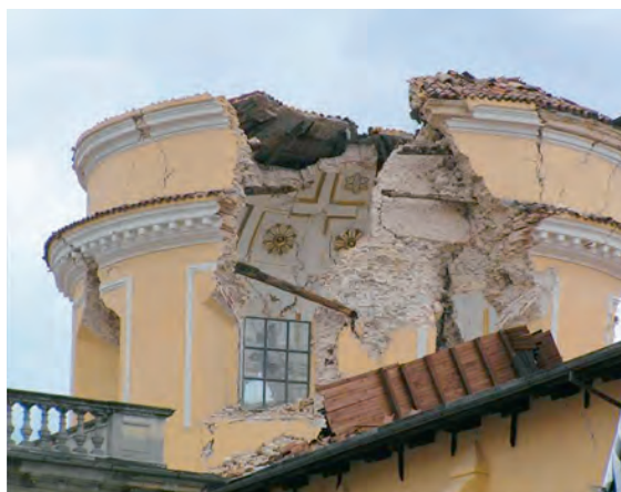
Fig. 1: Etat d'endommagement de bâtiments en maçonnerie et de bâtiments en béton armé après le tremblement de terre d'avril 2009 à L'Aquila (Italie).
