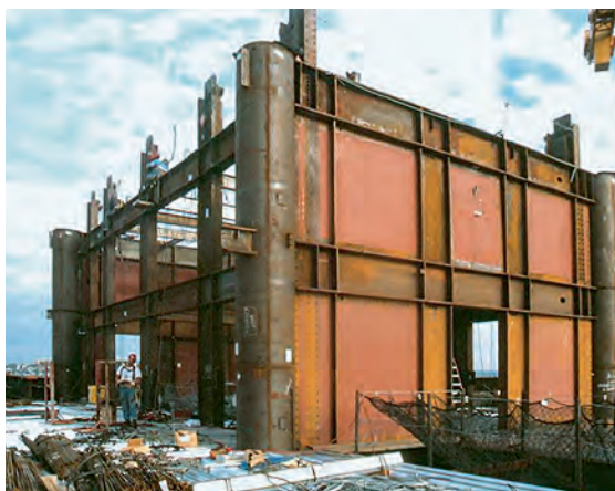
Fig. 24: Les systèmes à panneaux sont très efficaces et avantageux, Federal Court House (Seattle).
