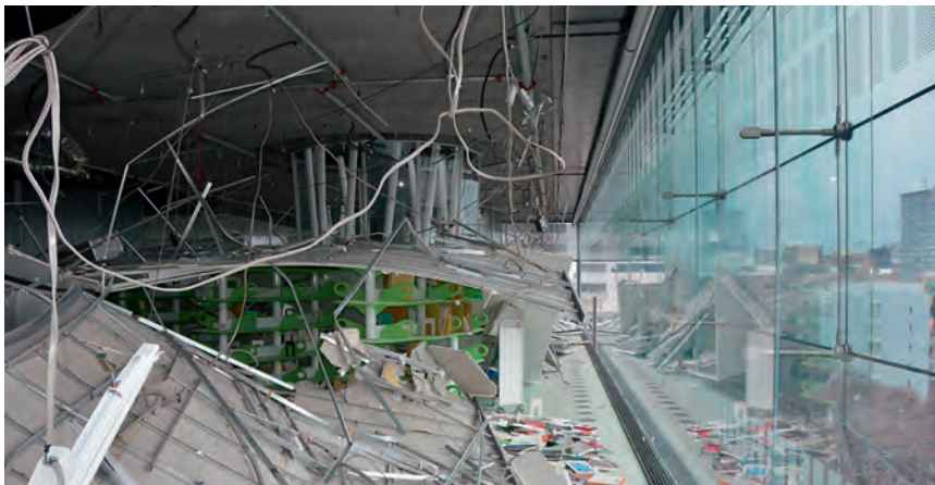
Des parties du plafond suspendu du septième étage sont tombées lors du tremblement de terre.
