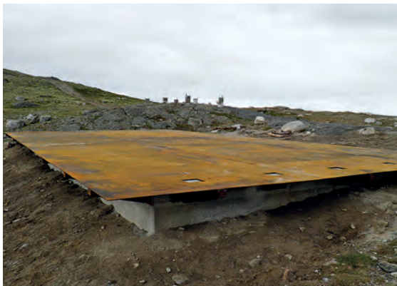
Des consoles métalliques supportent le porte-à-faux du plancher, qui gagne ainsi de la surface tout en donnant l'illusion d'un bâtiment décollé de son assise. Les ouvertures carrées dans les plaques métalliques permettent d'ancrer les poteaux dans la dalle en béton armé.
