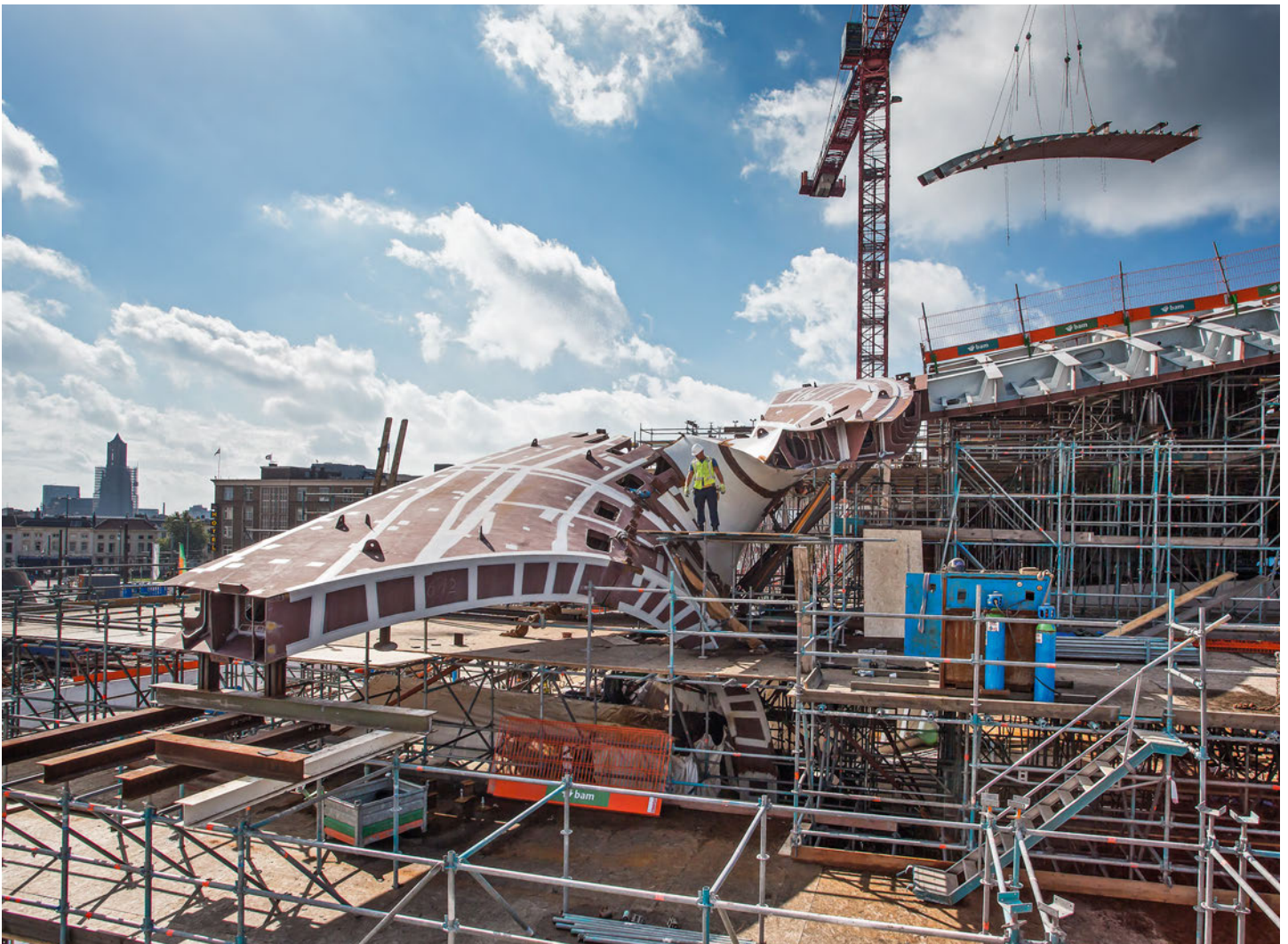
Installation du parement supérieur sur les membrures de la « coque de navire » inversée.
