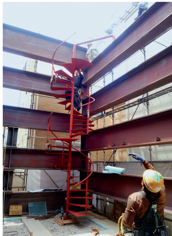
Un chantier à l'étroit : les poutrelles ont été empilées au moyen d'une grue pneumatique ; les maisons voisines sont toutes proches.
