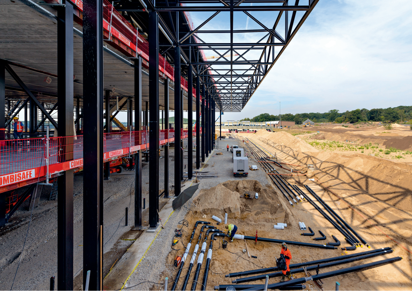
Le chantier, dans le paysage sablonneux de l'ancienne base aérienne militaire de Soesterberg.
