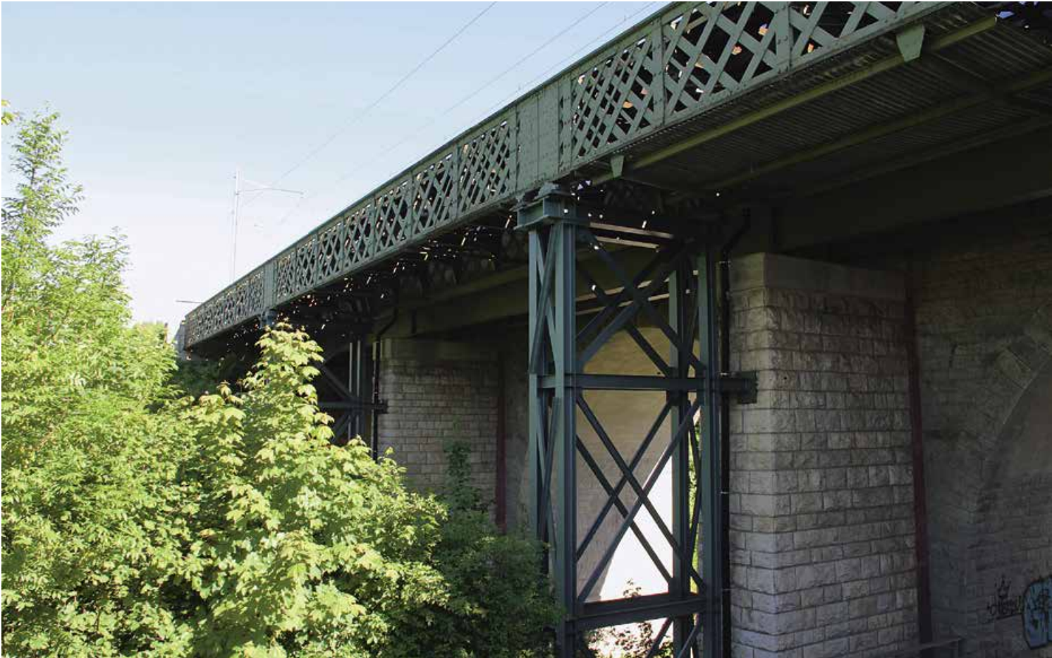
2 Die Frenkebrücke in Liestal aus einem dreifeldrigen Gitterträger steht heute als Denkmal neben der Bahnlinie Basel – Olten. Im Querschnitt sind die beiden Gitterträger auf halber Höhe H-förmig miteinander verbunden.
