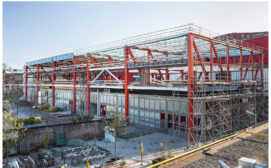
Der zweigeschossige Neubau überspannt das bestehende Gebäude als Tischkonstruktion aus sieben parallel zueinander stehenden, 34 m weit spannenden Stahlrahmen.
