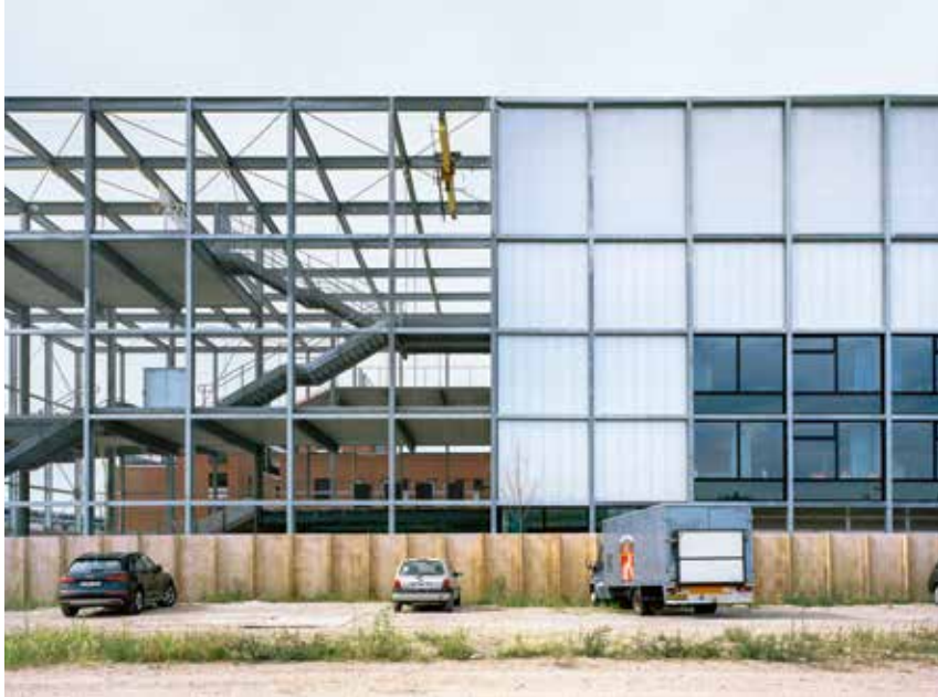
Oben: Ansicht der Süd-fassade. Ein einheitlicher Stahlraster verbindet den geschlossenen und den offenen Gebäudeteil miteinander.
