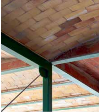
Le principe du voûtain d'origine prussienne transféré au XXI e siècle : la « Brick Vault House » près de Valence (ES) se caractérise dans l'espace par la combinaison d'une structure en acier légère et de voûtes en briques plates posées sur les poutres.
