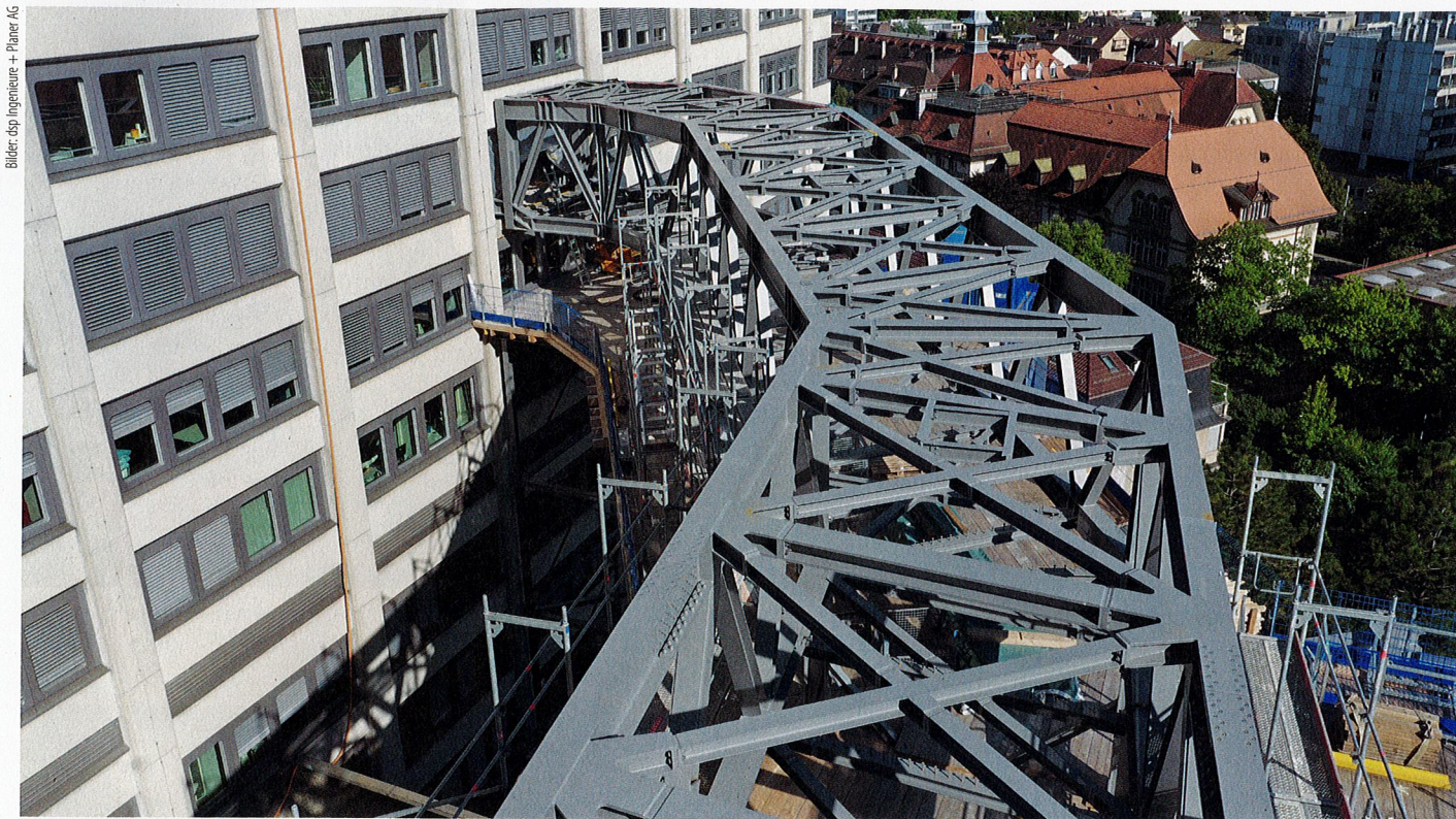
Für den Bau der Passerelle vom neuen Hauptgebäude zur Kinderklinik waren umfassende Vorstudien nötig, um den optimalen Verlauf zu ermitteln.
