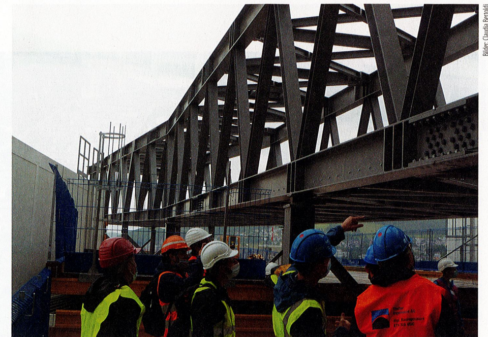
Baustellenbesichtigung beim im Ausbau befindlichen neuen Hauptgebäude des Inselspitals: Der Grossteil der Fachwerkteile der Passerelle ist bereits montiert.
