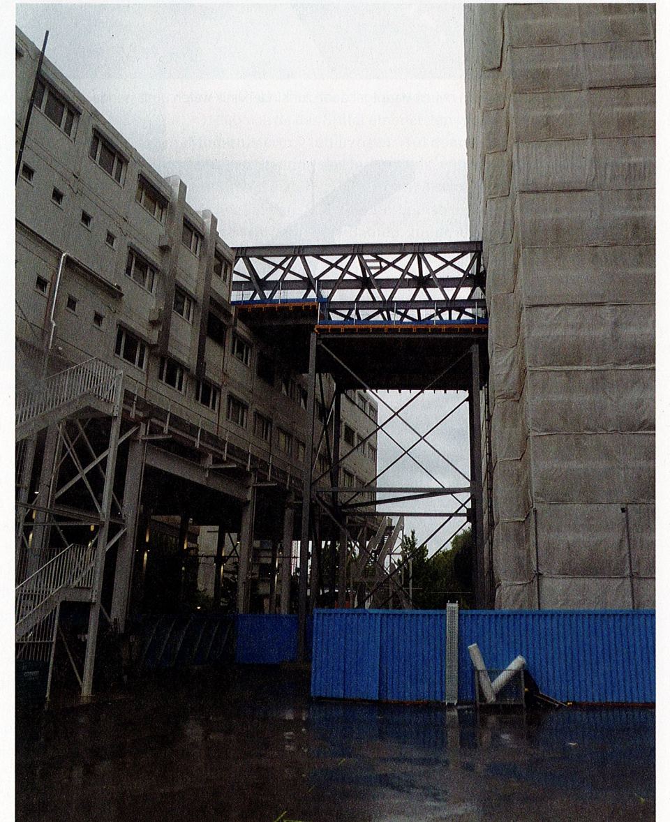
Der Bau der Passerelle vom Neubau des Hauptgebäudes (links) zur Kinderklinik erfolgte in einer Höhe von 18,6 Metern über Strassenniveau.
